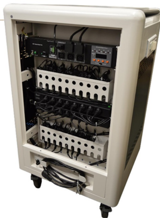
Exemple de zone technique câblé
